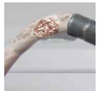
Betriebssicherheit geht vor: Austausch von gebrochenen, offenen Isolierungen
