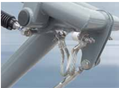
Erneuerte Hauptlager, neue Strombänder: optimale Betriebssicherheit
