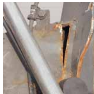
Bruch der Kupplungsstangen-Einhängung, ausgelöst durch beschädigte Fahrleitung
