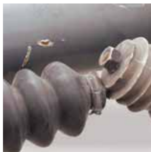
Gebrochene Antriebsspindel eines Dachstromabnehmers, verursacht durch starke Fremdeinwirkung
